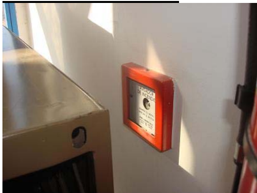
Sistema de alarma sin funcionar.
