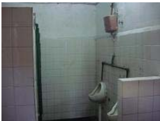
Deterioro en baños.
