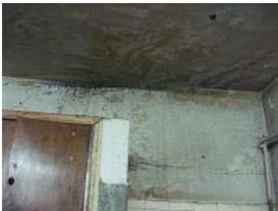
Estado de deterioro de la losa.
